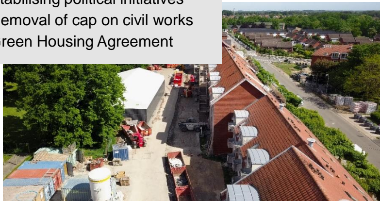
Enemærke & Petersen is future-proofing and refurbishing 587 council flats in Højstrupparken in Odense for FAB.
